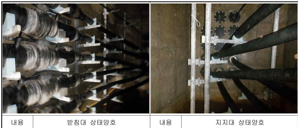
【사진 10.21】 부속 및 부대설비 현황
